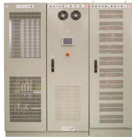
写真-1 蓄電システム
